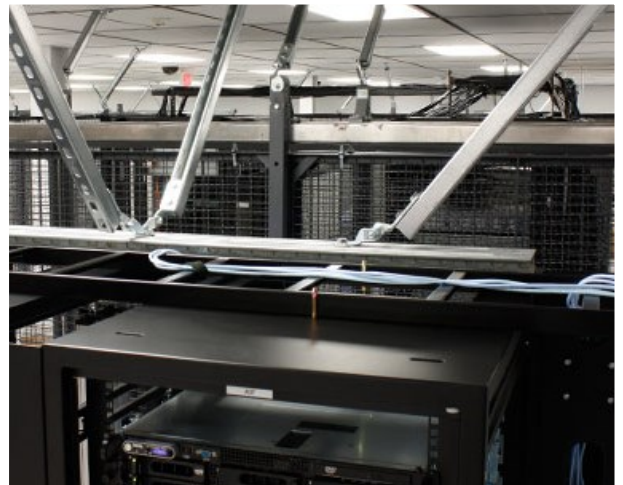
Unistrut rigid seismic bracing
